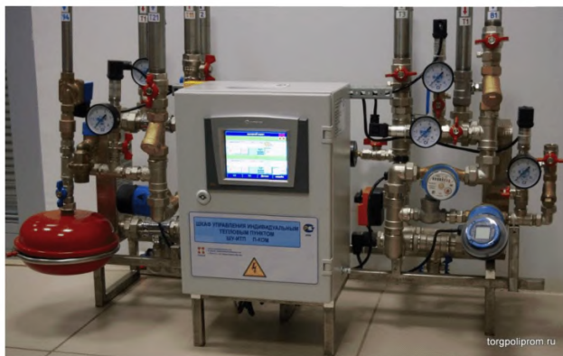
Рисунок 9.2 – Помещение системы теплоснабжения
