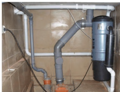
Рисунок 8.1 – Техническое помещение с установленным агрегатом централизованной системы пылеудаления
